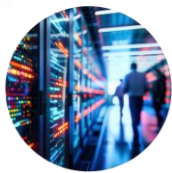
ศูนย์ข้อมูล (Data Center)
